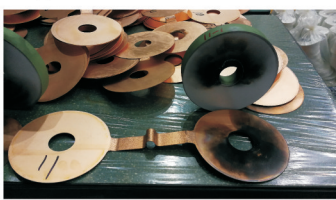
(d) 合闸电阻片和片间连接铜片放电情况
